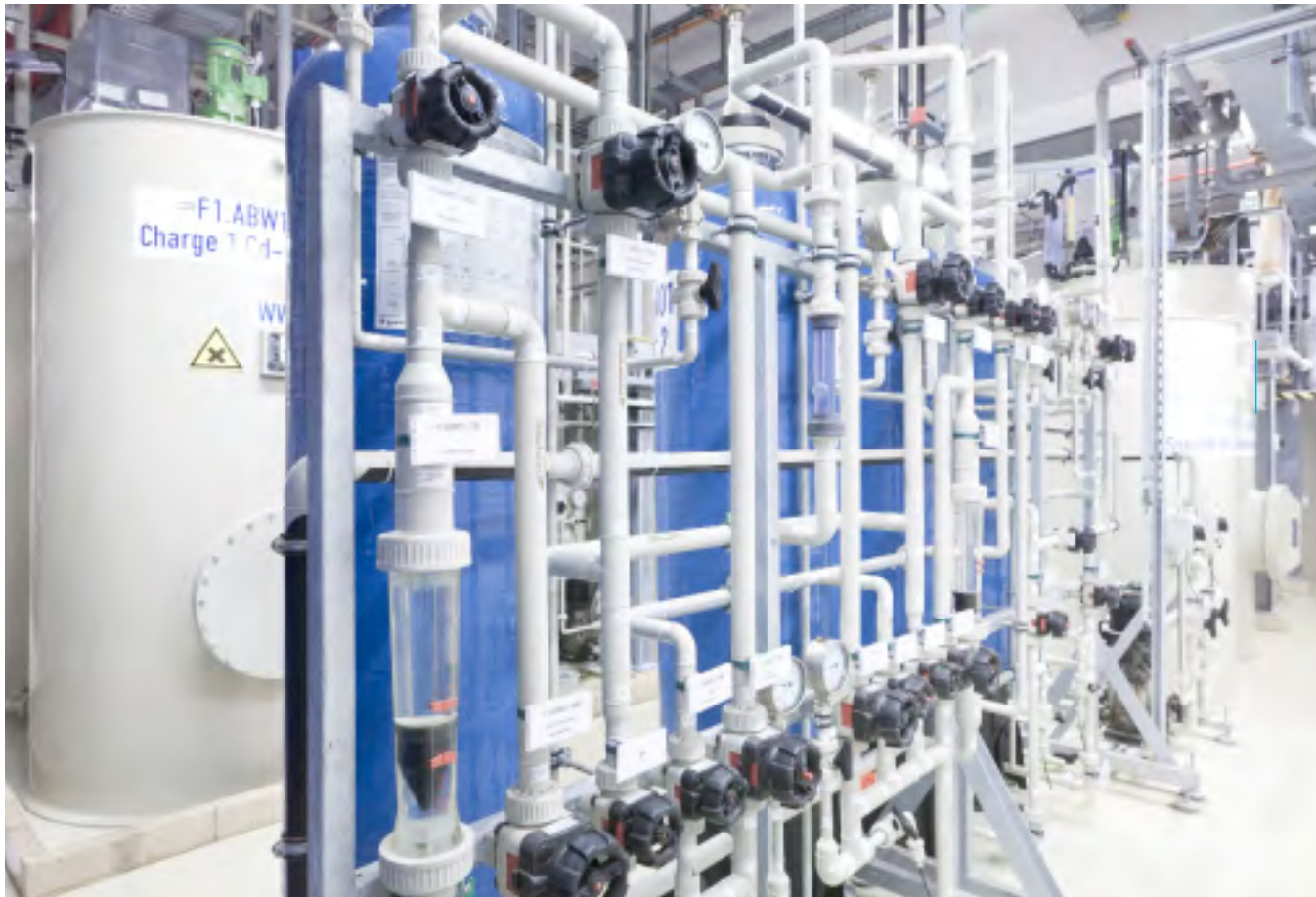
Установка селективного ионного обмена для удаления кадмия.
